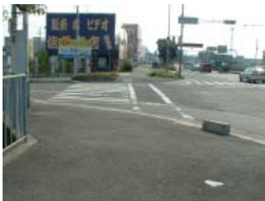
※1 横断歩道の損傷状況
