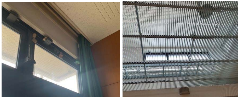
○信達公民館多目的ホールの排煙装置（左）、文化ホール展示室の排煙装置（右） （令和4年8月18日撮影（左）、令和4年7月28日監査人撮影（右））
