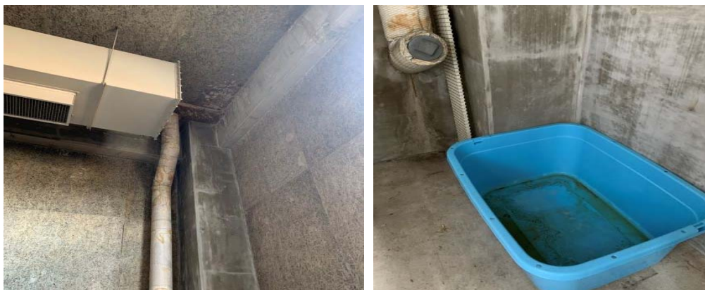
○文化ホール変電設備室内の雨漏り（大型バケツを常備して雨水を受けている） （令和4年7月28日監査人撮影）
