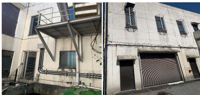
○双子川浄苑の外壁クラック、雨漏り（令和4年8月18日監査人撮影）
