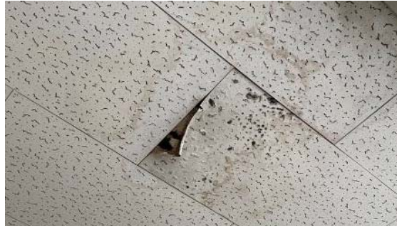
○新家小学校教室天井剥離（令和4年8月24日監査人撮影）
