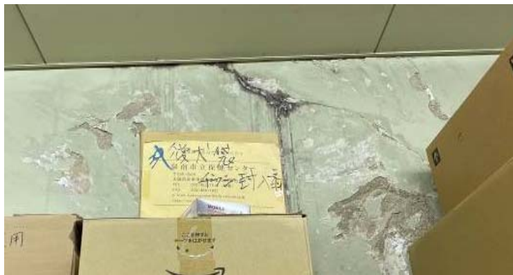
○保健センター１階倉庫内のクラック（令和４年８月２２日監査人撮影）
