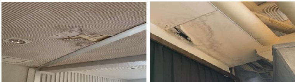
○第1競技場2階階段天井、2階通路天井雨漏り（令和4年8月10日監査人撮影）
