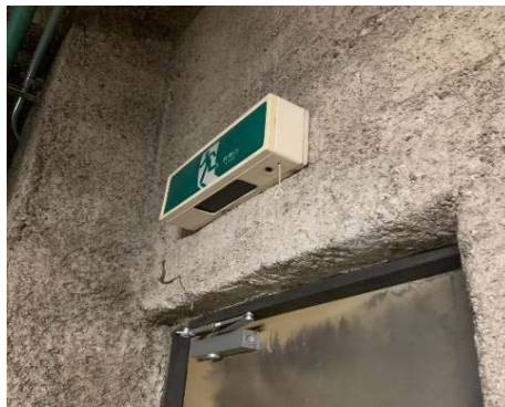
○非常灯が点灯していない（令和４年８月１８日監査人撮影）
