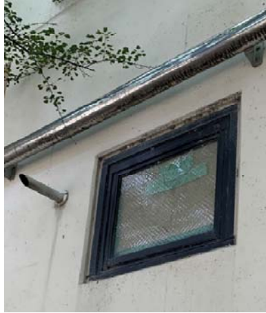
○第1 競技場外壁窓の割れ（令和4年8月10日監査人撮影）
