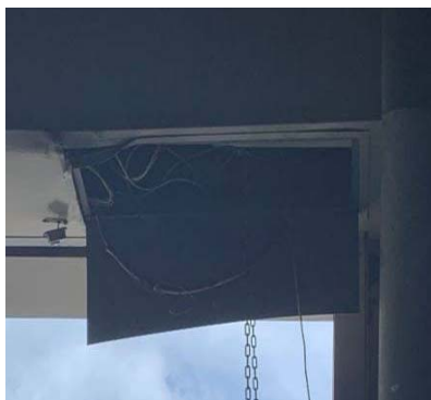
○清掃庁舎車庫の入口上部の破損（令和4年8月10日監査人撮影）
