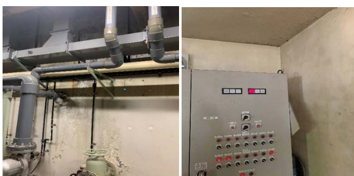
○双子川浄苑内の設備付近のクラック、雨漏り（令和4年8月18日監査人撮影）
