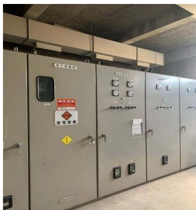
○上記雨漏り付近の電気設備（令和4年7月28日監査人撮影）
