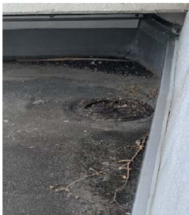
○第1 競技場 2階バルコニーの排水溝の詰まり（令和4年8月10日監査人撮影）
