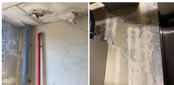
○双子川浄苑内部のクラック、雨漏り（令和4年8月18日監査人撮影）
