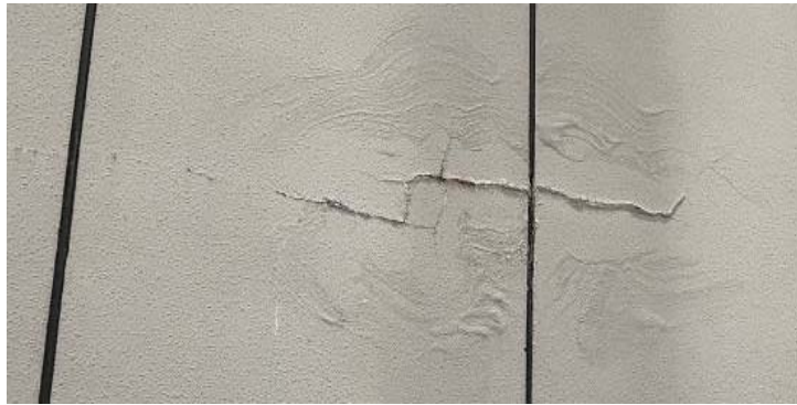
○保健センター階段横壁のクラック（令和４年８月２２日監査人撮影）
