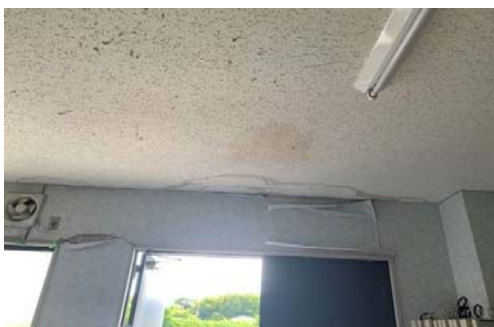
○文化ホール 1 階天井雨漏り（令和 4 年 7 月 28 日監査人撮影）
