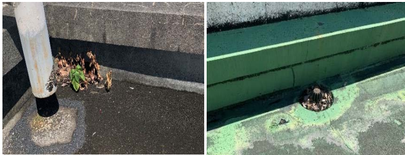
○屋上部分の排水溝の詰まり（令和４年８月１８日監査人撮影）
