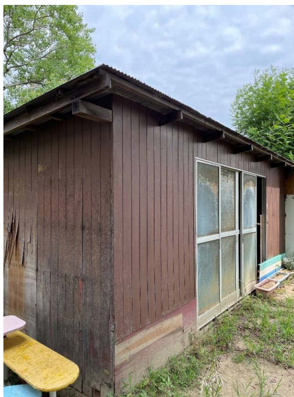
○あおぞら幼稚園園庭倉庫（令和４年８月２４日監査人撮影）
