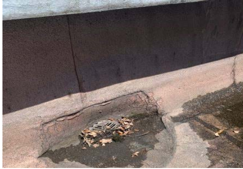
○文化ホール2階バルコニーの排水溝の詰まり（令和4年7月28日監査人撮影）
