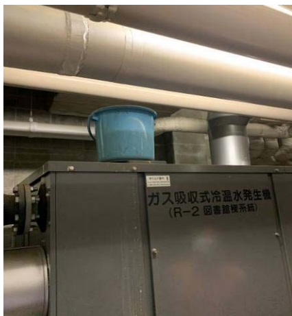
○文化ホール機械室内の空調配管の水漏れ（令和４年７月２８日監査人撮影）
