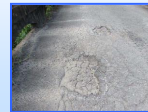
橋面舗装ひびわれ
