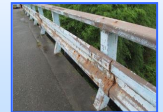
腐食（塗装劣化）
