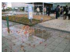
陥没し水たまりがある歩道
