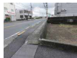
民地との高低差が大きく防護柵もない
