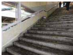
使いにくい手すり
