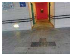
建物内の視覚障害者誘導用ブロックが分かりにくい
