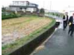
転落防止柵がない水路
