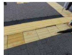
段差がある舗装仮復旧
