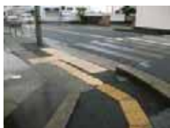
破損している視覚障害者誘導用ブロック
