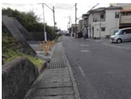
側溝蓋がデコボコしており歩きにくい
