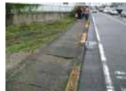
歩道の蓋の上が歩きにくい
