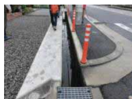
側溝に蓋がない
