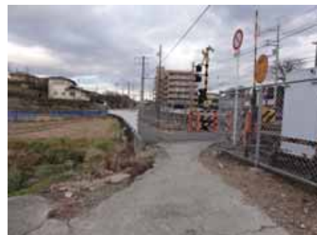
経路⑥の舗装破損箇所
