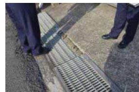
グレーチングの目が粗い
