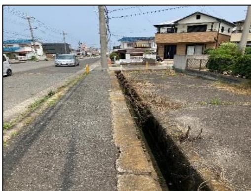
【歩道未改良区間】転落防止柵がない
