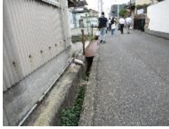
水路のフタがない
