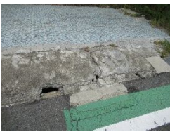
道路に穴が開いている
