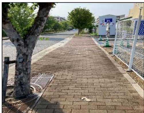
誘導用ブロックの連続性がない
