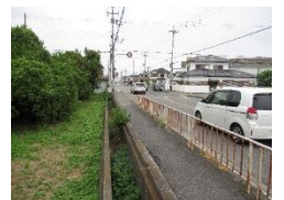
パン屋横の歩道の柵がさび て危険
