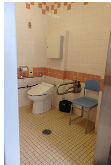
車いす対応トイレ
