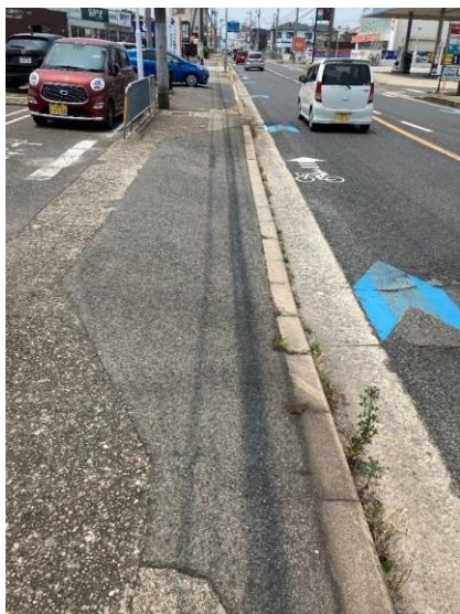
舗装面改善（未整備）
