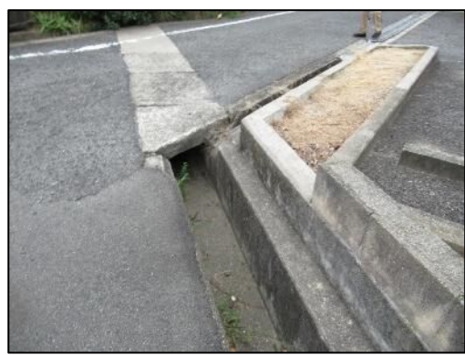
水路に蓋がない
