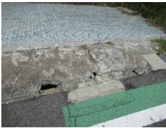
道路に穴が開いている
