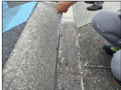
歩道と車道の段差
