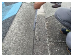
歩道と道路面との段差が きつすぎる
