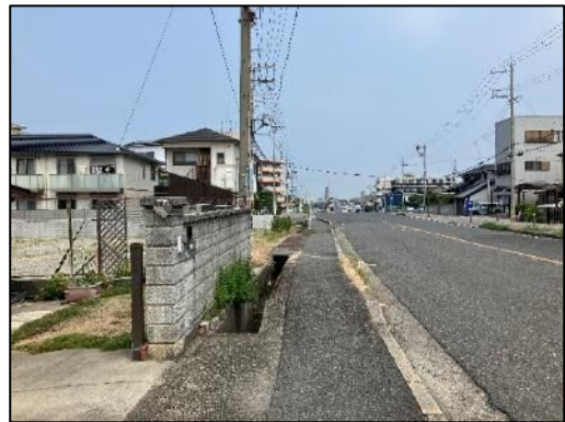
【歩道未改良区間】側溝蓋がない
