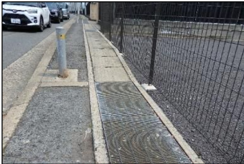
歩道の車止めが障害となっている
