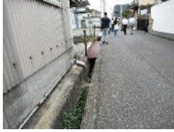
水路のフタがない
