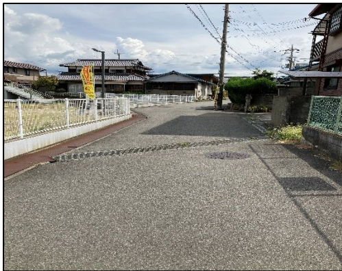
グレーチングの網目が粗い
