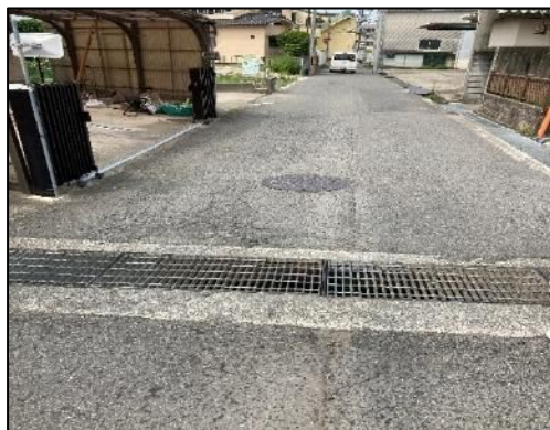
グレーチングの網目が粗い
