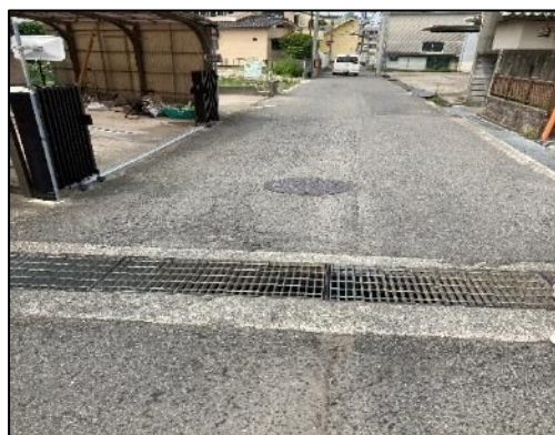
グレーチングの網目が粗い
