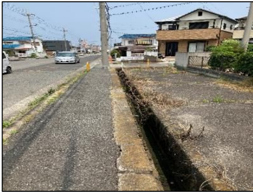
【歩道未改良区間】転落防止柵がない
