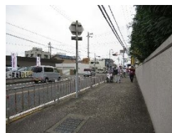
アスファルト舗装がない のでベビーカーが通行し にくい
