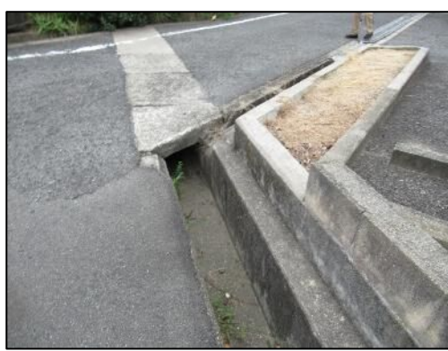
水路に蓋がない
