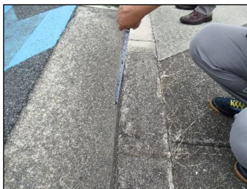
歩道と車道の段差
