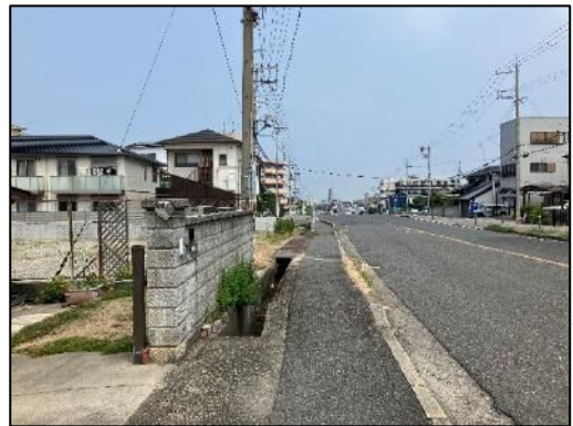
【歩道未改良区間】側溝蓋がない
