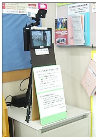
サーマルカメラの設置 (1F 閲覧室入口)
